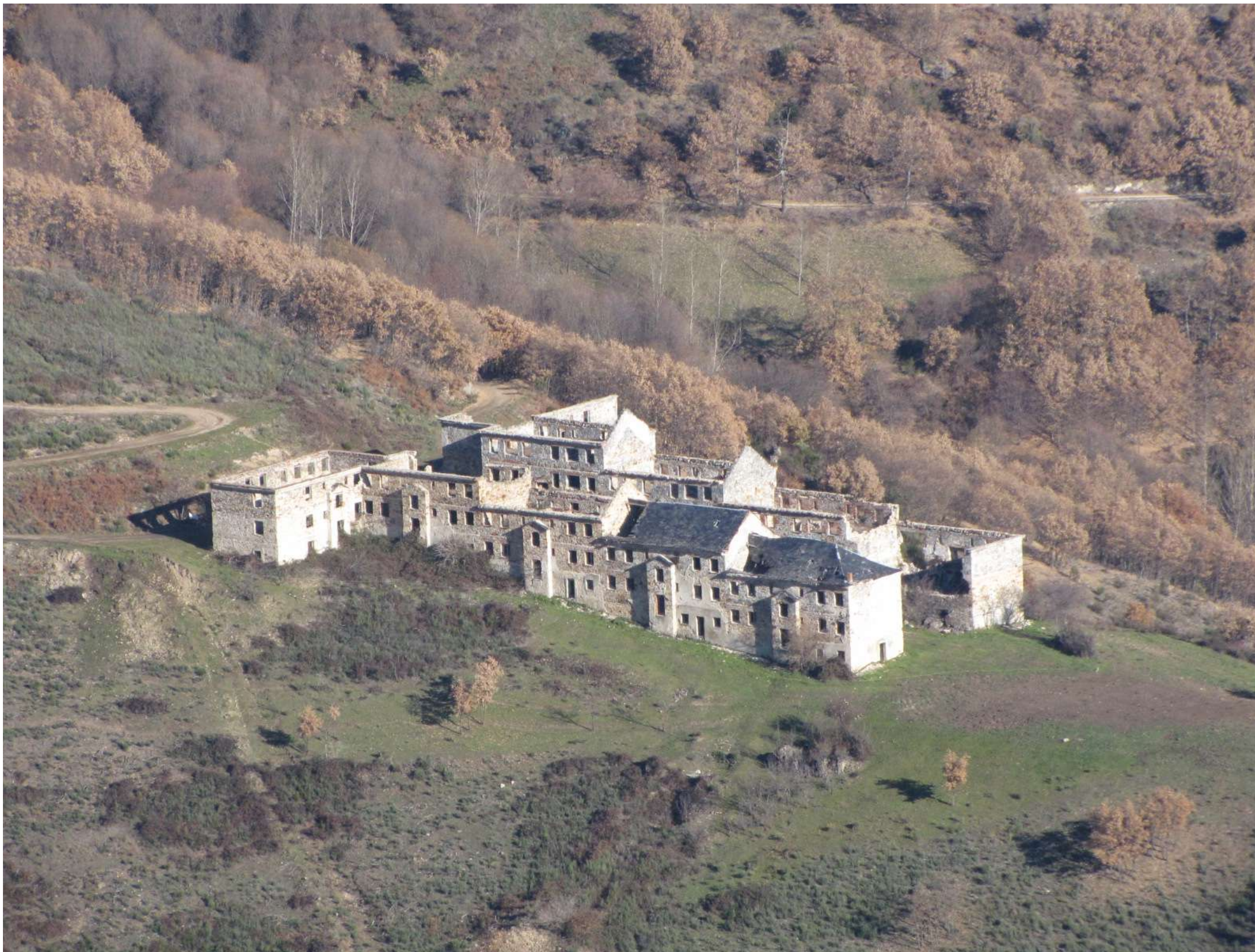
Poblado minero de "La Puela". Construido entre 1952-1953, estaba compuesto de 41 viviendas de 60 metros cuadrados cada una. Actualmente se encuentra en estado ruinoso.
